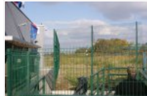
Budowa budynku odpraw granicznych dla podróżnych w Drogowym Przejściu Granicznym Medyka - Szeginie
