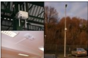
Rozbudowa i utrzymanie platformy teleinformatycznej Straży Granicznej - zaprojektowanie i uruchomienie WLAN
